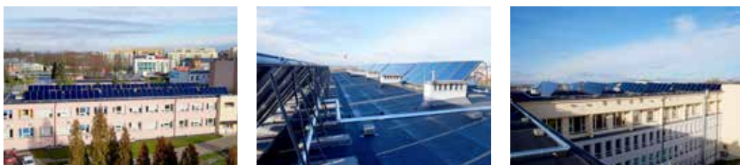
Kolektory słoneczne na budynkach szpitala
